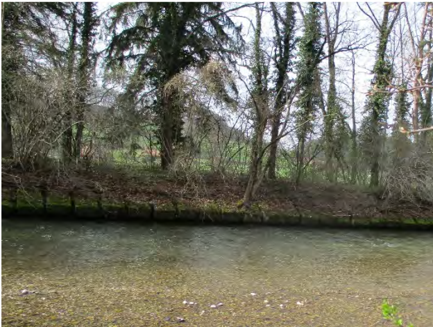
Abbildung 4.3 Unterspülter Uferverbau auf dem Gemeindegebiet von Bösinggen (Km 1.80 bis 2.0)
